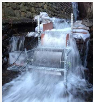
発電機現地設置状況
