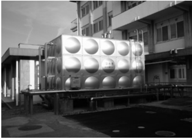
本館系統受水槽(改修後)
