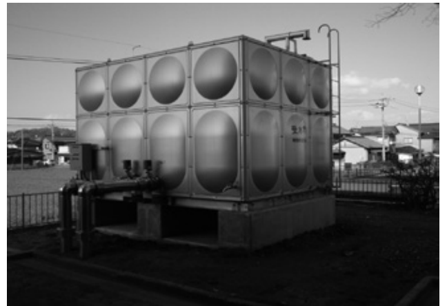
電子情報工学科系受水槽(改修後)
