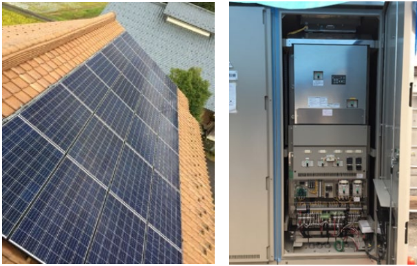
図1 防災 GND 設備の例（施設 A）
