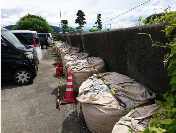
図2 熊本地震の被害の一例（益城町公民館付近の擁壁の被害）
