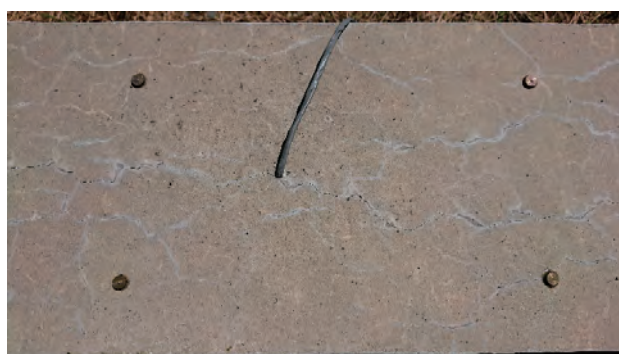
ASR による膨張ひび割れ
