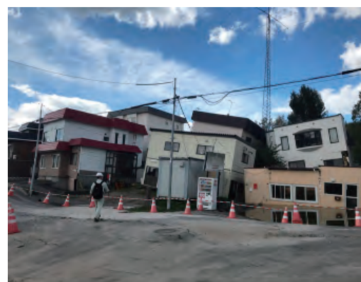
写真1 傾斜した家屋(液状化)
