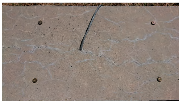
ASR による膨張ひび割れ
