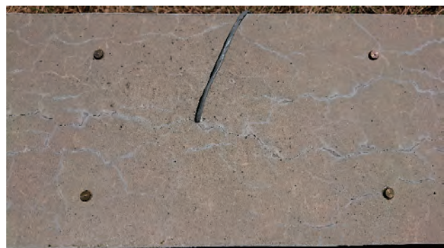
ASR による膨張ひび割れ
