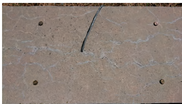
ASR による膨張ひび割れ
