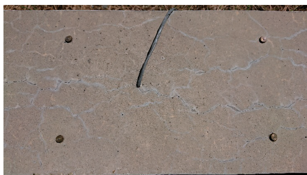
ASR による膨張ひび割れ
