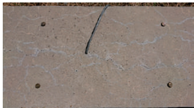
ASR による膨張ひび割れ
