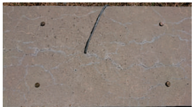
ASR による膨張ひび割れ
