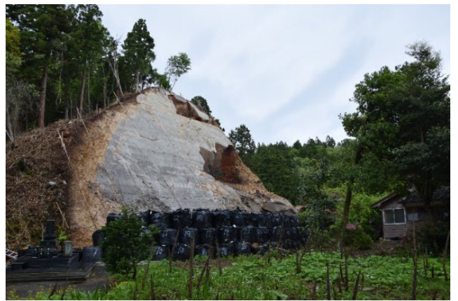
図 11 崖崩れによる家屋の一部損壊 (図 1④)
