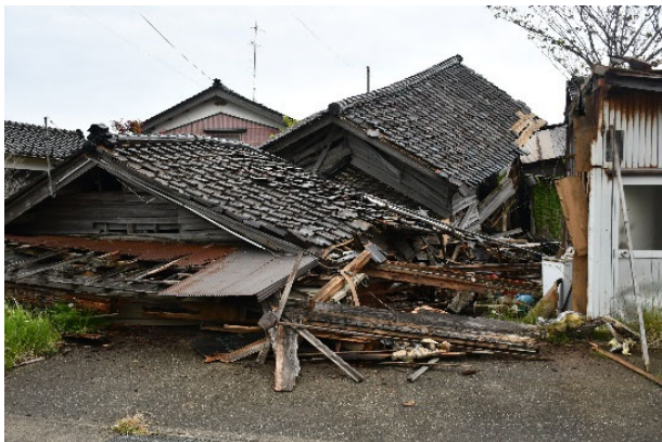
図 3 倉庫の全壊(珠洲市正院町正院, 図 1②)
