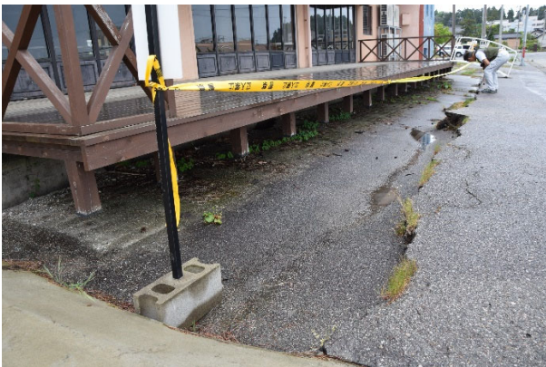
図 14 商業施設の周辺地盤の沈下 (図 1⑥)
