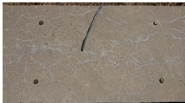
ASR による膨張ひび割れ
