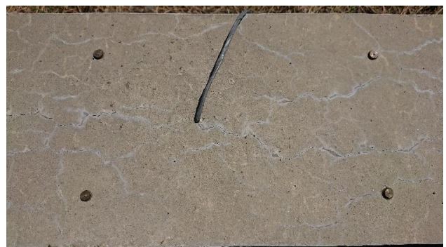
ASR による膨張ひび割れ
