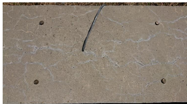
ASR による膨張ひび割れ
